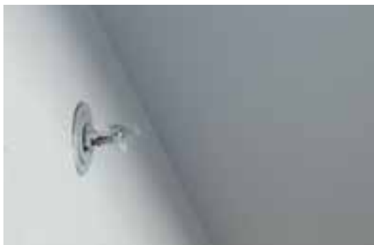
Sprinkler på vägg
