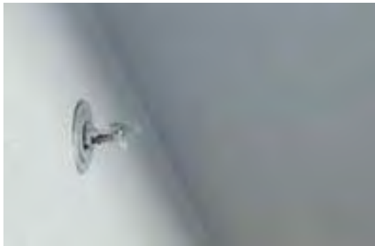
Sprinkler på vägg
